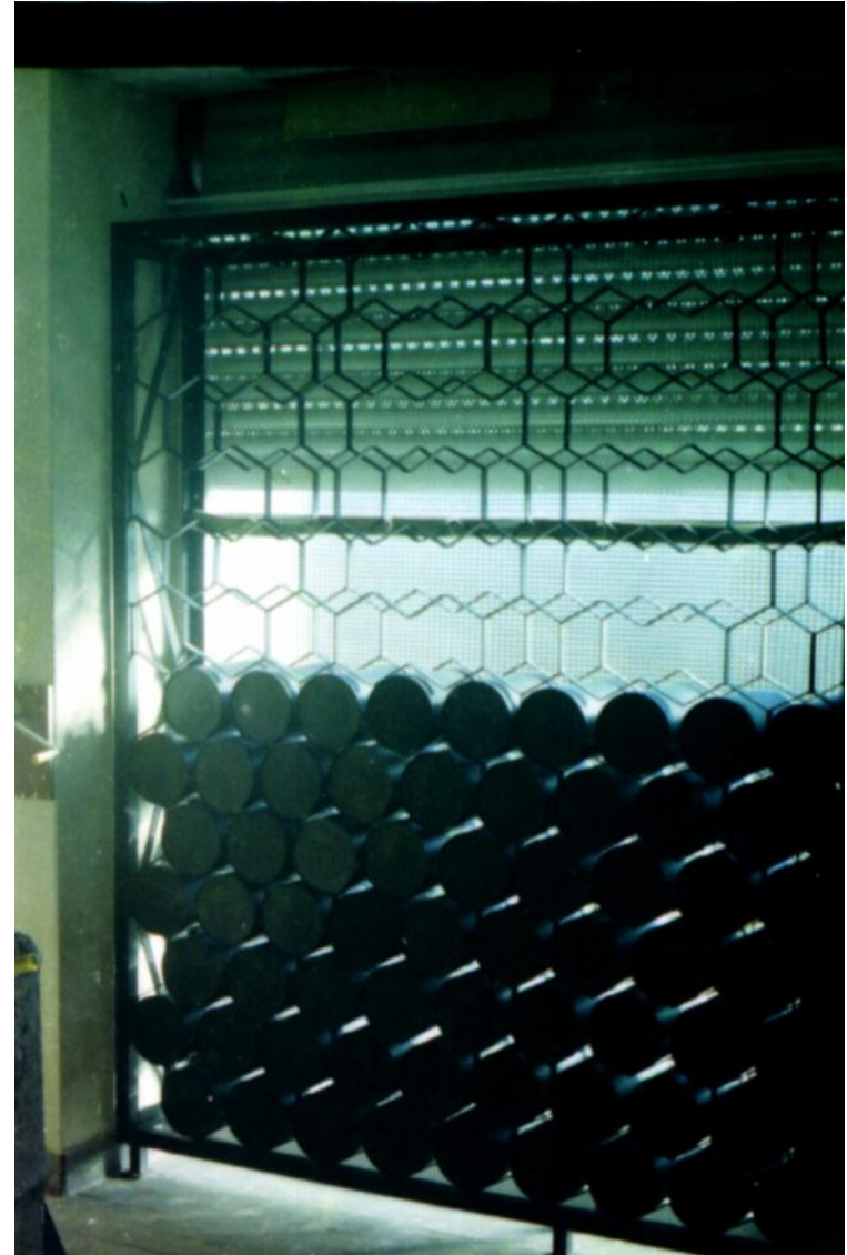
Muro Acumulador de Calor (MAC) de agua.
